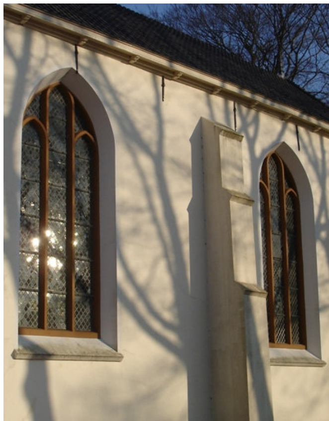
De steunberen die het dak stutten waren in 1862 weggehaald maar in 1930 weer teruggeplaatst omdat de zijmuren begonnen te wijken.
